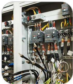
分·配电盘/电气室
